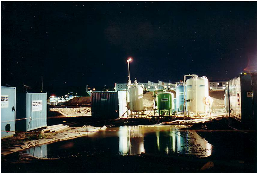
Wasseraufbereitungsanlage und Vorratsbecken
