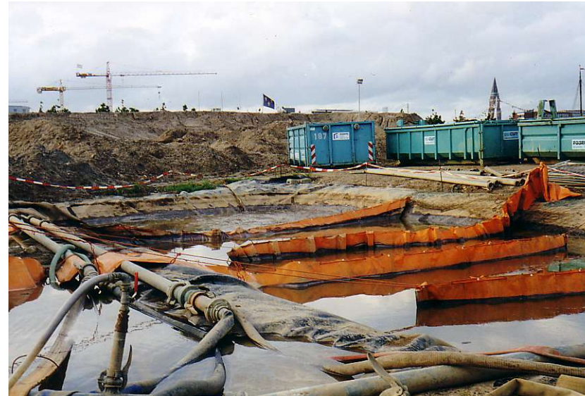
Vorlagebecken der Wasseraufbereitungsanlage mit Beruhigung
